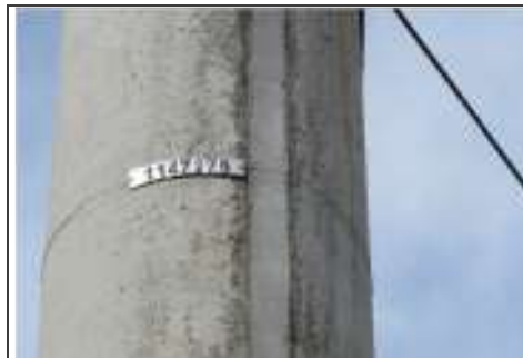
6 A foto mostra nº identificação do poste.
