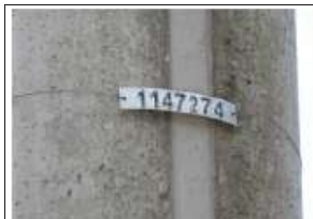
6 A foto mostra nº identificação do poste.
